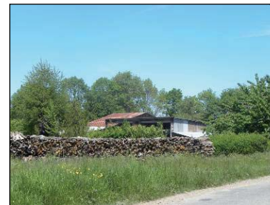
Façade et couverture de toiture en tôle (présence de rouille)
